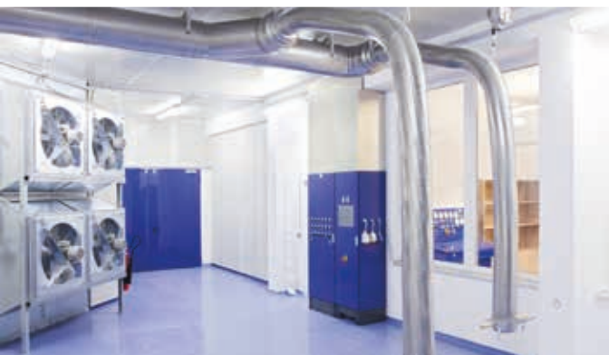
Prüfstand für Aggregate in der NTC-Zentrale
